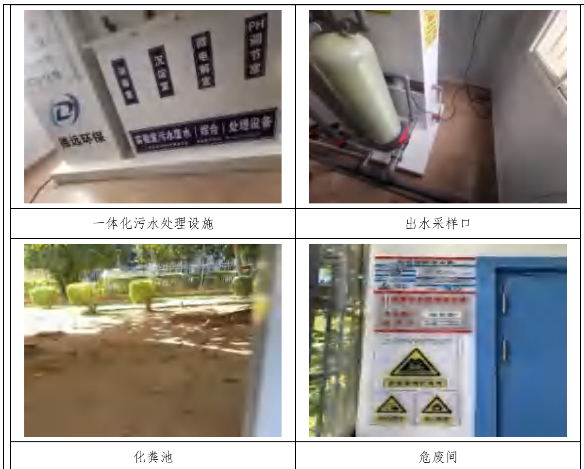
图 3-2 项目废水处理措施现状图
