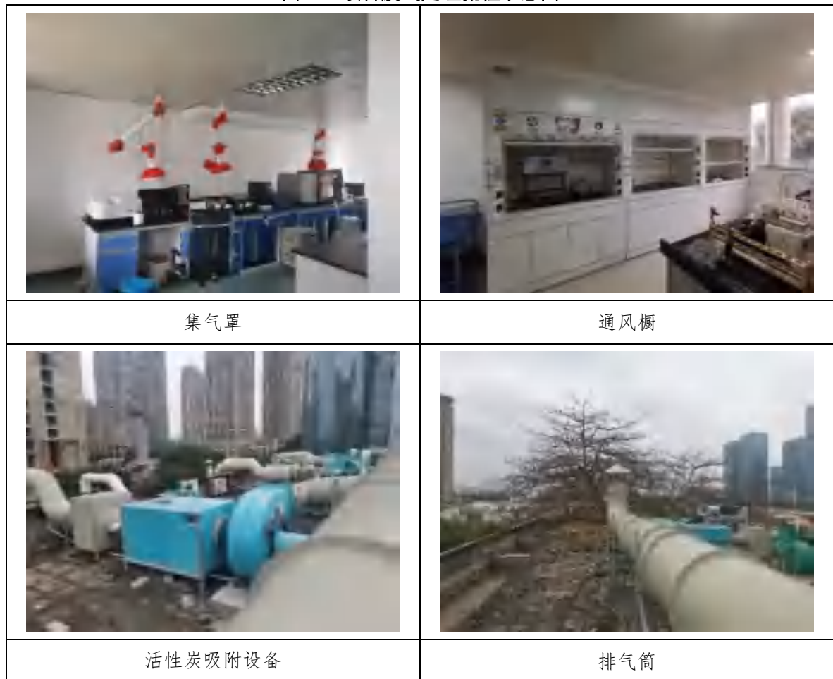
图 3-4 项目废气处理措施现状图
